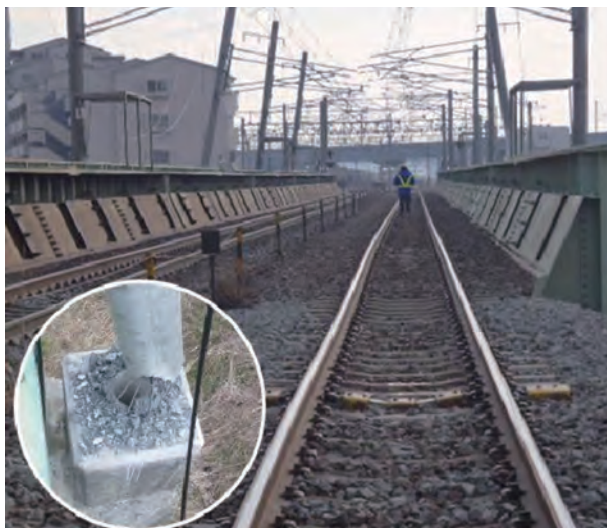
写真 2.2.7 電化柱の損傷（岩切駅構内）
