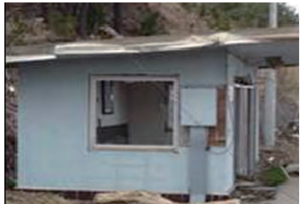
写真 2.2.28 駅舎損傷（有家駅）
