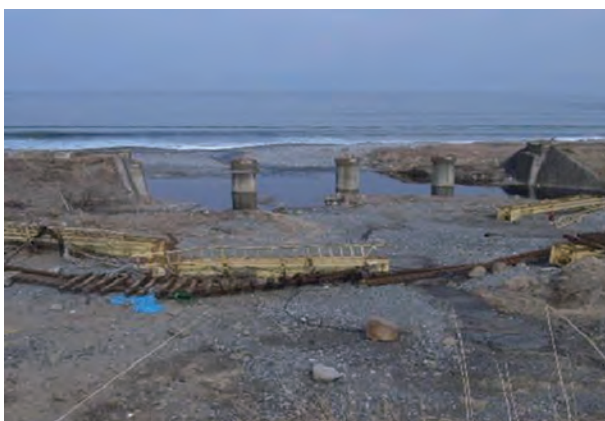
写真 2.2.27 橋桁流出（大浜川橋りょう）
