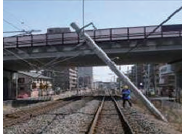
写真 2.2.15 電化柱の折損(苦竹駅～小鶴新田駅間)
