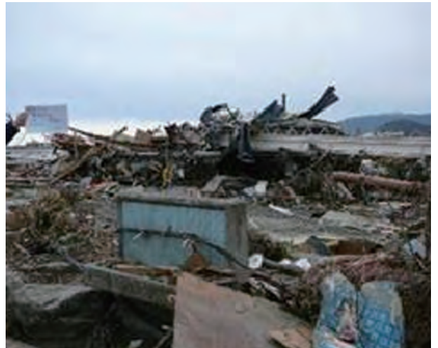
写真 2.2.45 駅舎損傷(陸前高田駅)
