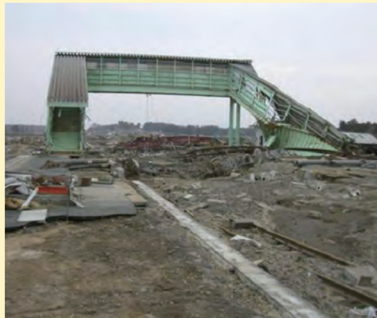
写真 2 震災後の流失した新地駅
