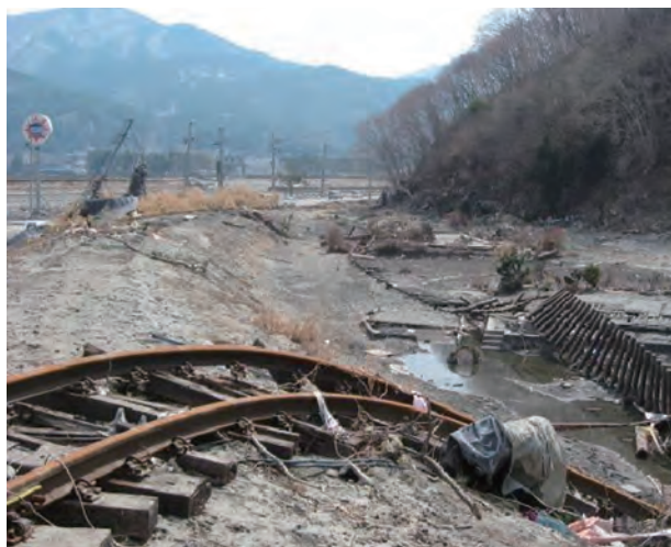
写真 2.2.36 線路流失（磯鶏駅～津軽石駅）
