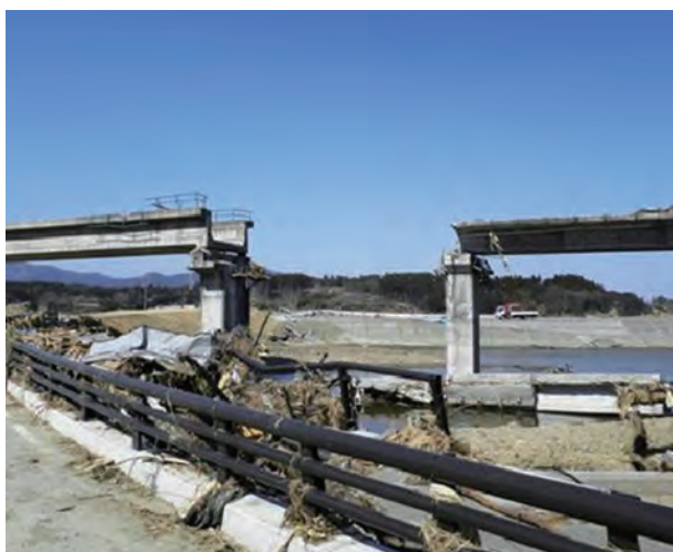
写真 2.2.22 橋桁の流失（陸前小泉駅～本吉駅間）
