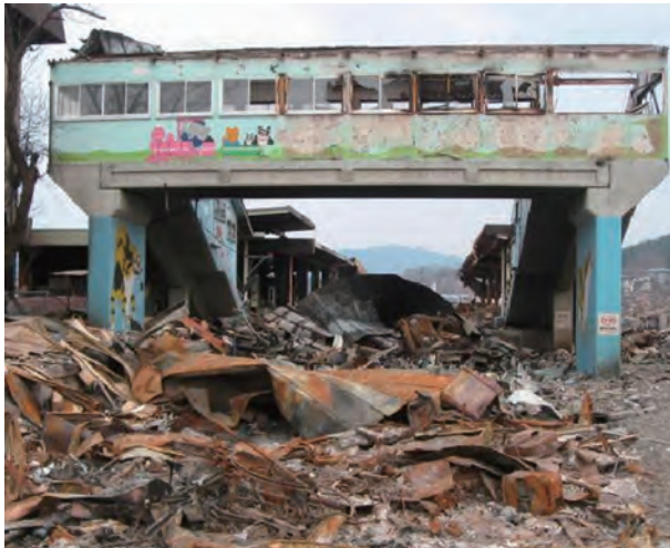
写真 2.2.40 駅舎流出（陸前山田駅）
