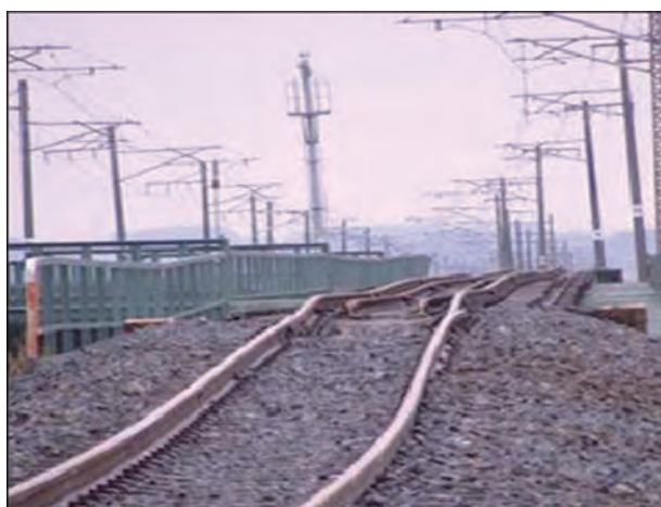
写真 2.2.49 橋桁の沈下（小牛田駅構内）
