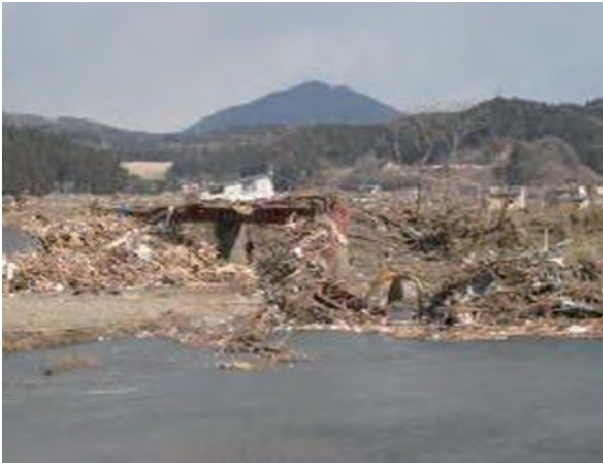
写真 2.2.44 橋桁・橋脚流出(気仙川橋りょう)
