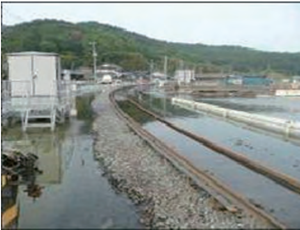
写真 2.2.17 線路の冠水（沢田駅～浦宿駅間）
