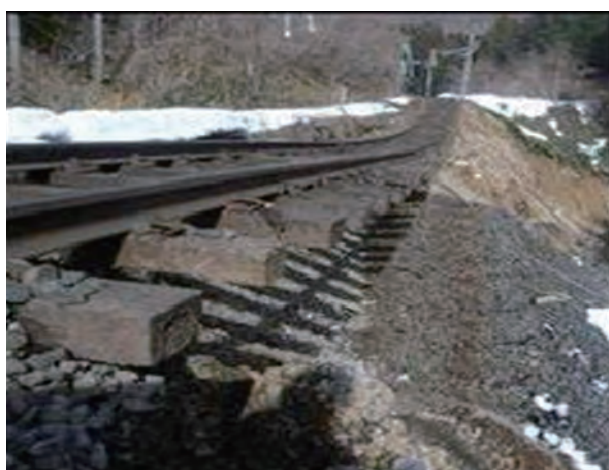
写真 2.2.48 盛土の崩壊（仙山線）
