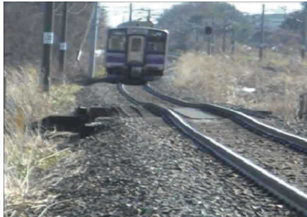
写真 2.2.5 軌道の変位（村崎野駅～花巻駅間）
