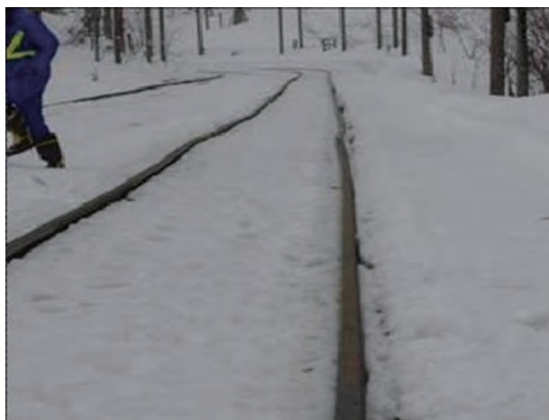
写真 2.2.47 軌道の変位（奥羽本線）
