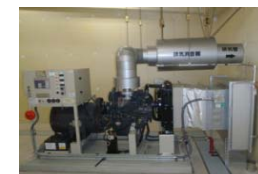
非常用発電設備
