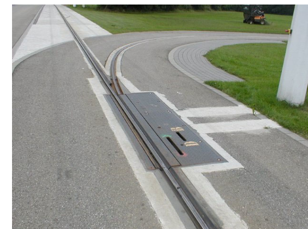
↑: トランスロール用の分岐装置。写真はレールに平行な回転軸を中心に直線レールと曲線レールを有する箱が回転する「回転型分岐装置」で、この他に、地面に対して垂直な回転軸を中心にレールが左右に転換する「水平転換型分岐装置」も開発中です。
