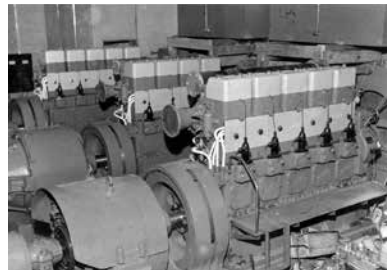
東京天文台乗鞍岳コロナ観測所に納入したディーゼル発電装置
