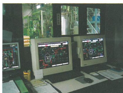
安富工場コンピュータ制御室
