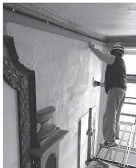
修理中の2階旧議場の漆喰壁。建築当初は薄いクリーム色（黄大津）であったことが分かり、本工事で復元します。
