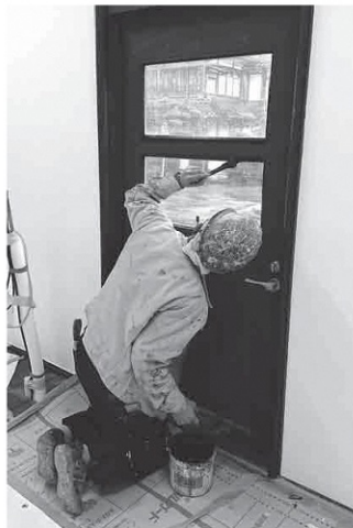
建築時の建具の色味に合わせて調合された塗料が仕上げに塗られています。細部までいねいに工事が進められました
