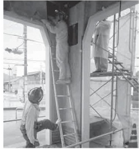
昨年9月の耐久性調査。車寄せ内部の木材が、腐朽により粉々になっていました
