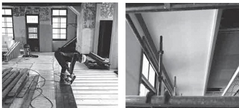
左／1階の床板を張る様子 右／2階旧議場の大津壁と折上げ天井の白漆喰塗り部分
