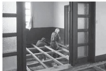
旧庁舎で木部の詳細調査を実施。白アリなどの虫による被害や腐朽、それらによる部材の欠損度合い、進行性のものであるかどうかなどを詳細に調査
