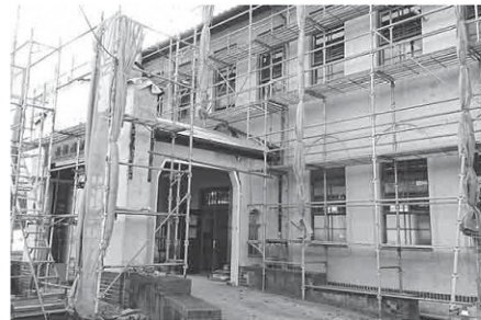
【足場が組まれた外壁】大規模に足場を組んだ機会を利用し、大屋根の状態も確認しました。雨漏りはありませんでしたが、大屋根の装飾にもなっている換気棟のアーチ型の窓枠が積層の木材でつくられていて、木部の経年劣化から、大雨の時に雨水が建物内に入り込むことが分かりました。今回の工事で修繕します。
