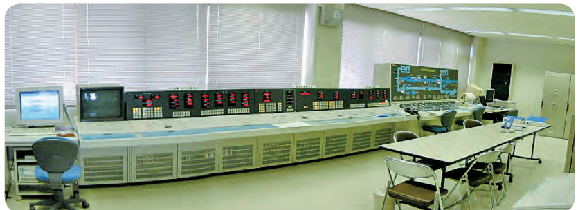
ダムやパイプラインを管理する部屋
