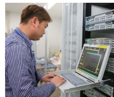
黒崎本社内にあるサーバ室。ネットワークの動作の確認を行っている様子。
