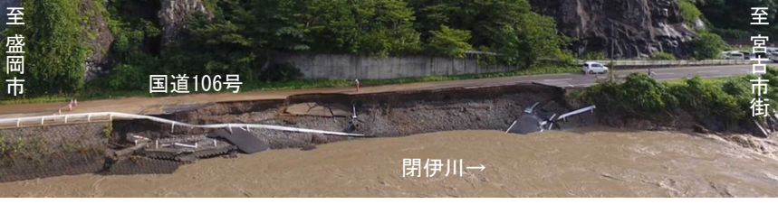
▲国道106号の被災状況(平成28年8月台風10号災害)
