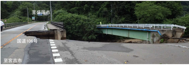
▲国道106号の被災状況(平成28年8月台風10号災害)
