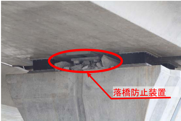
▲ 落橋防止装置(写真中央)の一部破壊
