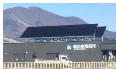
太陽光発電機・自家発電機
