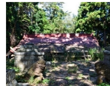
写真 -4-6 地震（余震）で倒壊した諏訪神社（双葉町）
