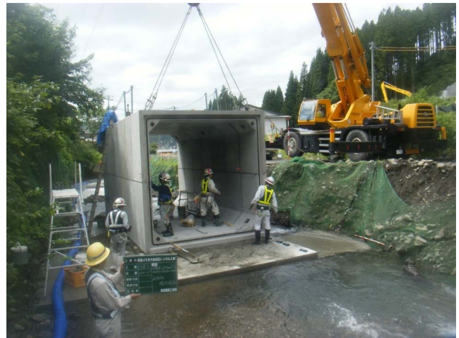
▲大槌IC～山田南IC 大槌地区の本線横断BOX設置状況②
