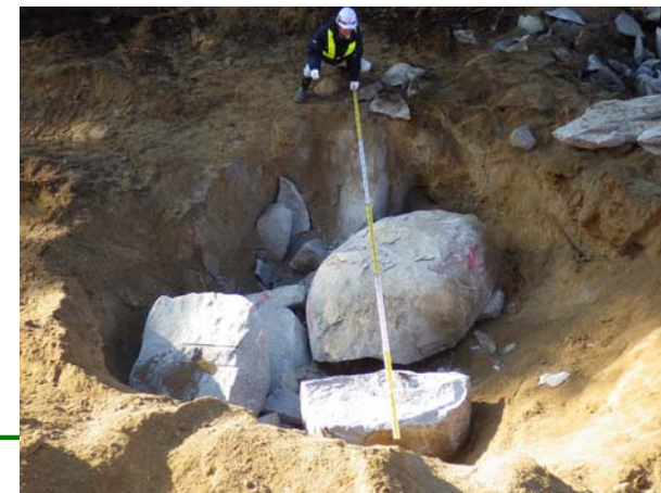
▼擁壁基礎部の転石発生状況
