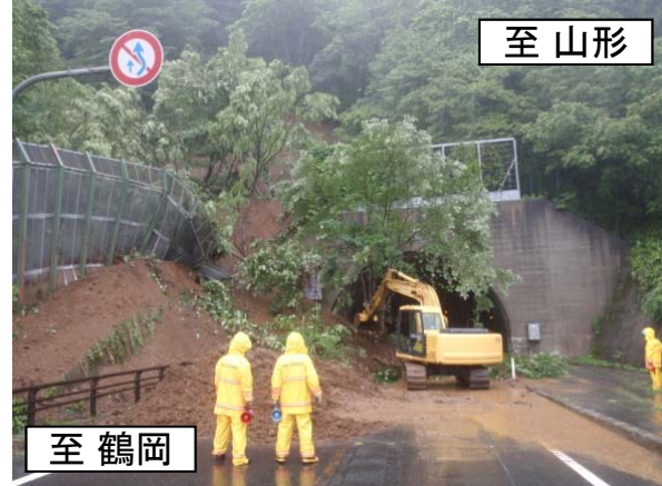
▲国道112号 西川町月山沢の土砂崩れ(H25年7月18日)
