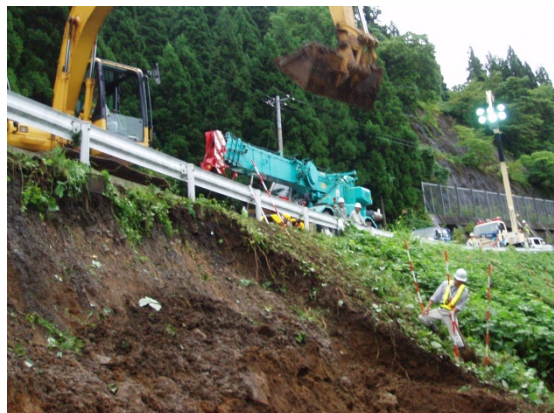
現道の盛土路肩崩落状況（H22.9.14）
