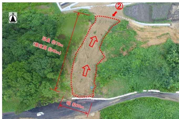
▲①斜面崩落状況 垂直
