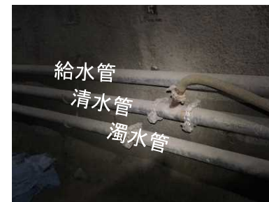
清水と濁水の分離配管
