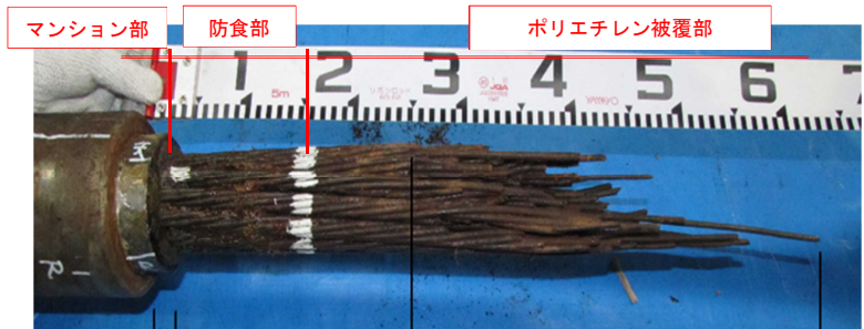
写真-3 破断ケーブル
