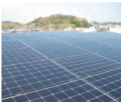
太陽光発電パネルの屋上設置
