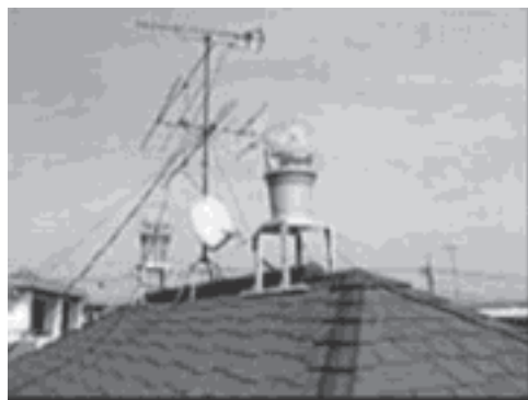
図 10. 採光システムの設置例 (写真提供ラフォーレエンジニアリング) 1)
