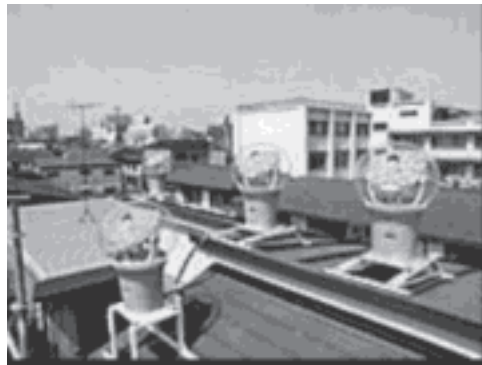
図 9. 採光システムの設置例 (写真提供ラフォーレエンジニアリング) 1)
