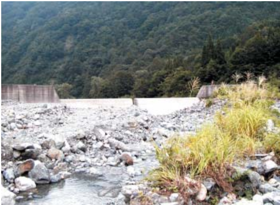
写真11 東股2号砂防えん堤 袖部に形成した堆砂面により土砂が抜け出たことがわかる(水通し幅40m)
