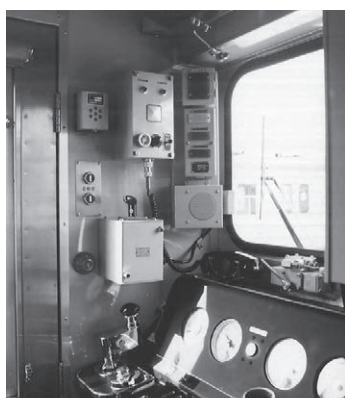
列車誘導無線装置
