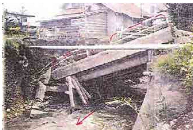
写真-23 昭和 56 年 8 月の水害（福住 1 号橋付近）
