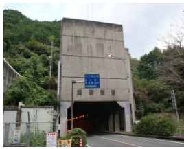
老朽化の進む現道の夜昼トンネル (八幡浜市側坑口)
