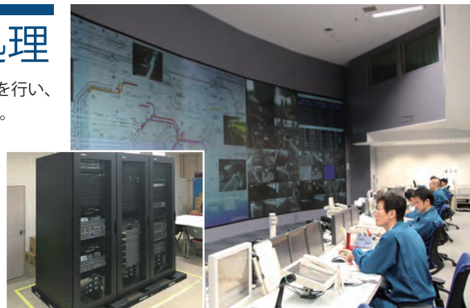
交通管制中央装置
