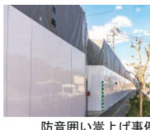
防音囲い嵩上げ事例
