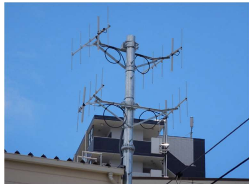
<地上基地局 アンテナ>
