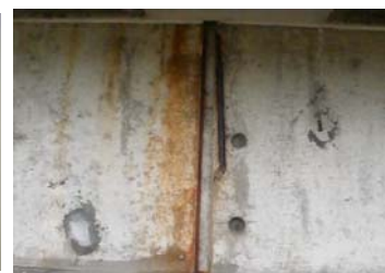
■ポー川博物館 外壁鉄筋 発錆
