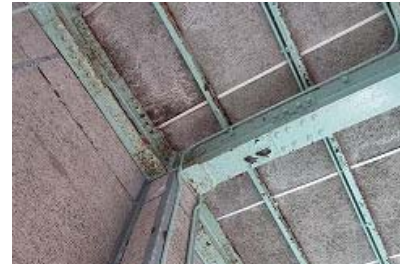
■屋内水泳プール鉄骨のさび
