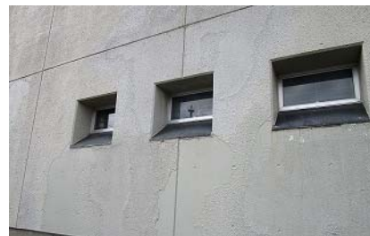
■総合体育館 外壁クラック
