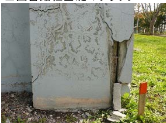
■図書館柱基礎のクラック
