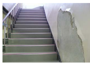
■図書館 階段室クラック
