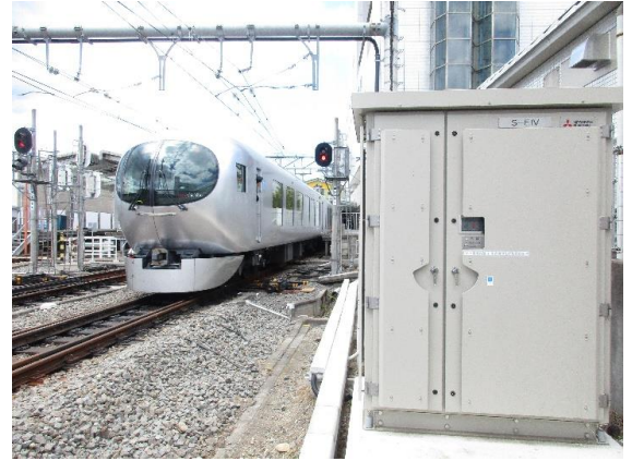
駅舎補助電源装置(飯能駅)
