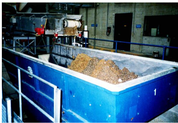
チューリッヒ市の下水処理場に集まってくる固形物は 木の葉が多い(平成 3 年)
