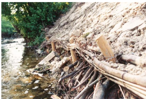
レピッシュ川の水際には施工直後の柳柵工があった (平成2年)
