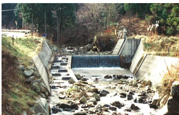
井山川の砂防堰堤には魚道が設置されていた がその入り口がわかりにくい(平成 4 年)
