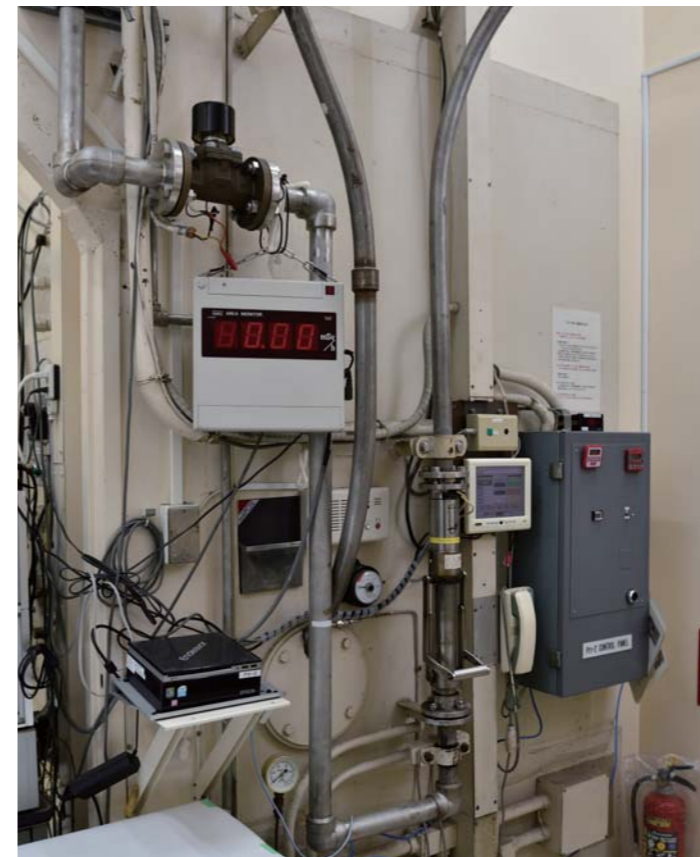
ジュニアケープの圧気輸送管ステーション
