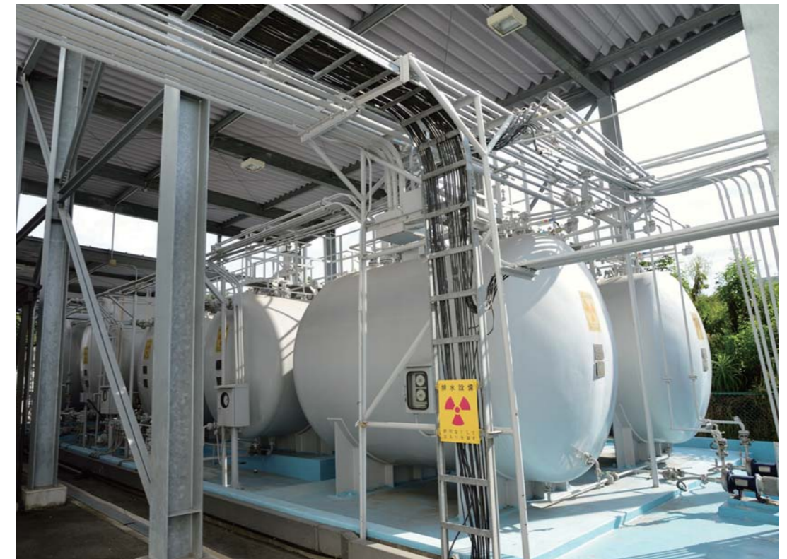
廃棄物処理設備タンクヤード
