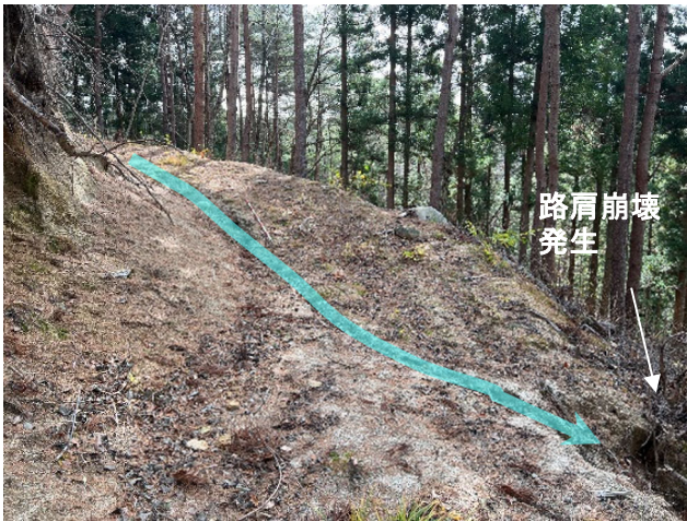
外カーブに流れ込んだ水による路肩崩壊の例
