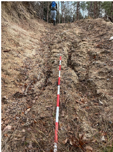
路面洗掘の事例
