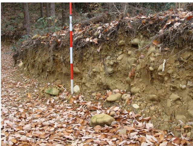
不均一さにより石礫が抜け落ちた切土のり面
