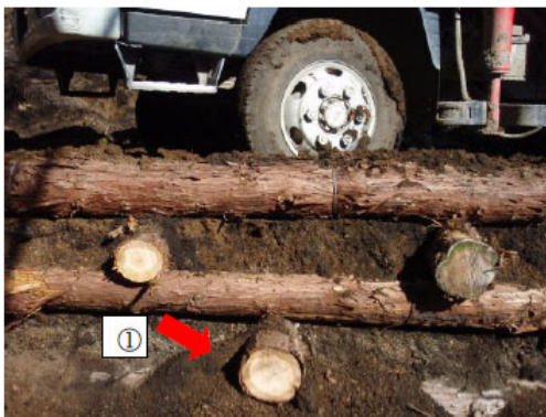
車輪のめり込みと丸太間からの土砂押出状況 (①横木や杭丸太の間から押出された土砂)
