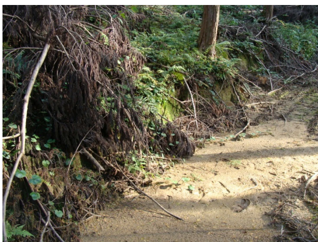
路面に堆積した軟弱な土砂
