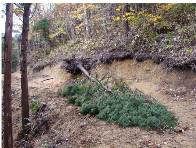
オーバーハングが発生しやすい土質の切土のり肩の立木
