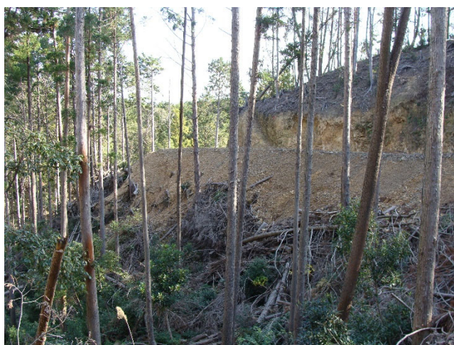
土羽尻からの盛土の流出
