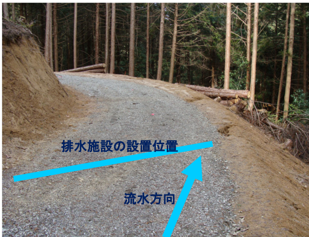
外カーブの流水の一例
