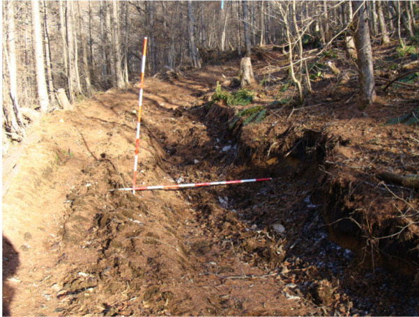
軟弱路盤走行による路盤の痛み
