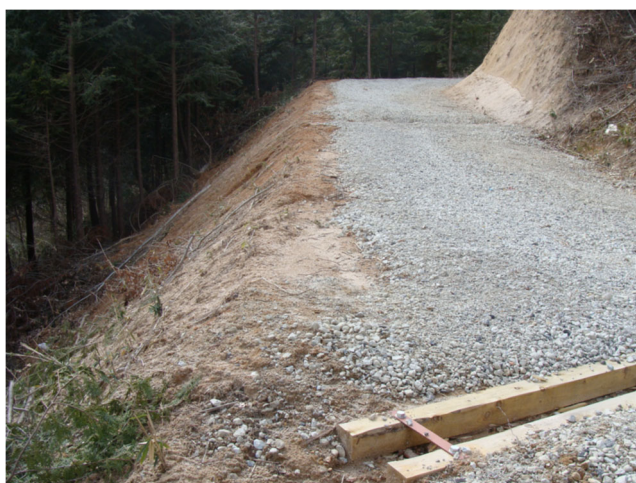
設置間隔 10m 程度であるが、盛土のり面に侵食が発生した事例
