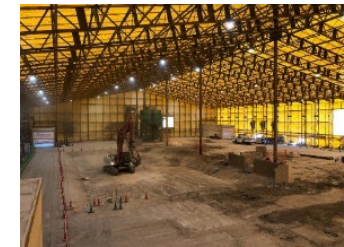
受入・分別施設 施設内(大熊町)
