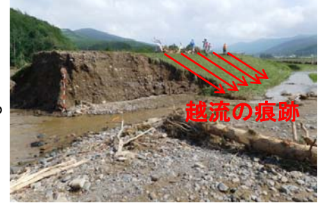
決壊口の上流端近傍の越流痕跡
