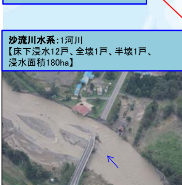
沙流川水系沙流川(被害状況)H28.8.31撮影
