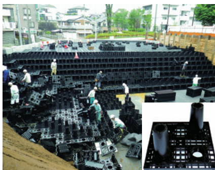
雨水貯留浸透システムユニット 写真提供：城東リプロン(株)
