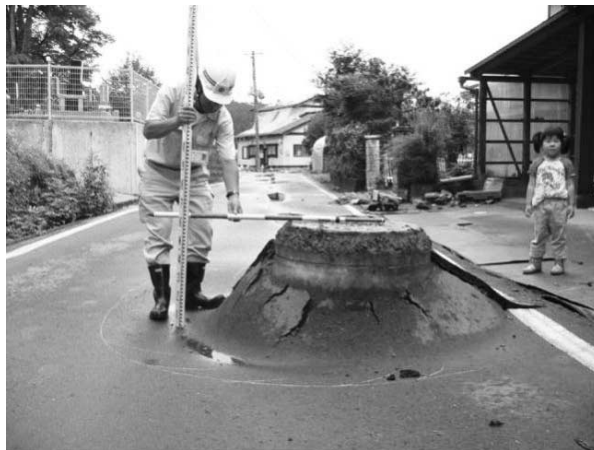
農業集落排水管路被災状況（柏崎市（旧西山町））
