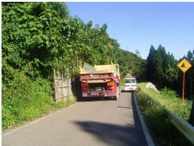
○ 幅員狭小ですれ違いが困難
