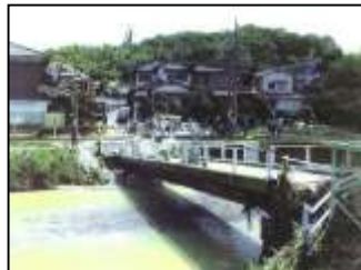
②小瀬工区(上田橋) (H12年7月被災時)
