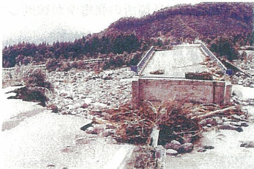
大倉川の橋梁落下 (平成元年8月6日洪水)
