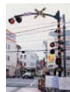
オーバーハング型踏切警報機
