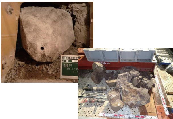
写真一4 ルーフ内支障物
