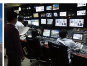
ニュース送出設備
