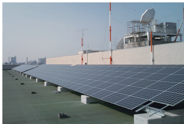
東京・渋谷 放送センターの太陽光発電パネル
