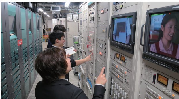
放送設備の定期点検の様子
