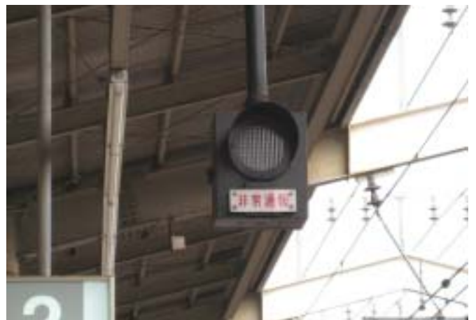
非常通報表示灯
