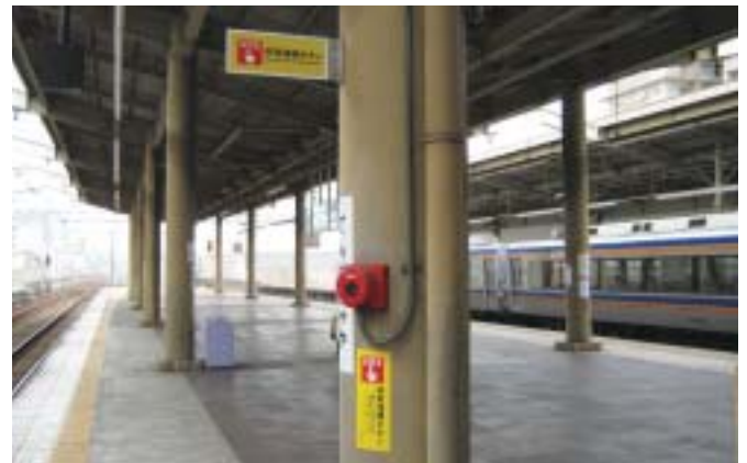
非常通報ボタン
