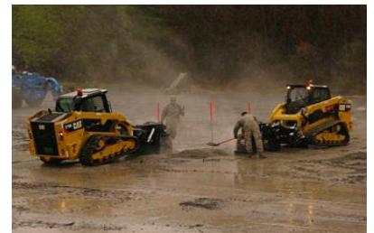
滑走路被害復旧器材
