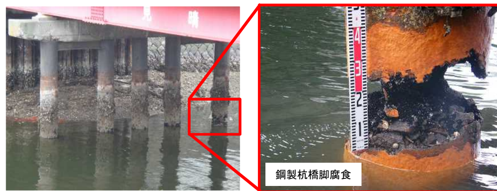
【重大な損傷の事例(橋梁)】
