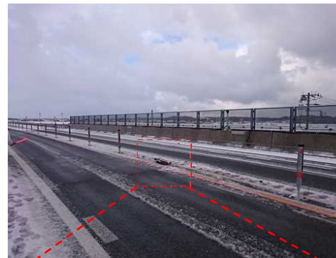
【破損状況 写真①】
