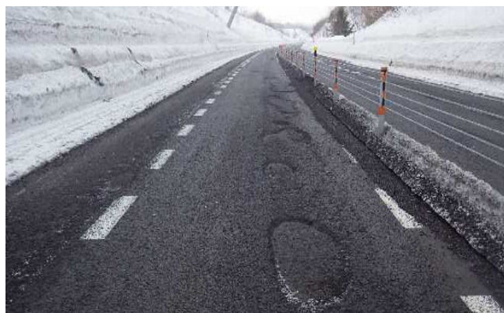
道央道(落部～八雲)の状況
