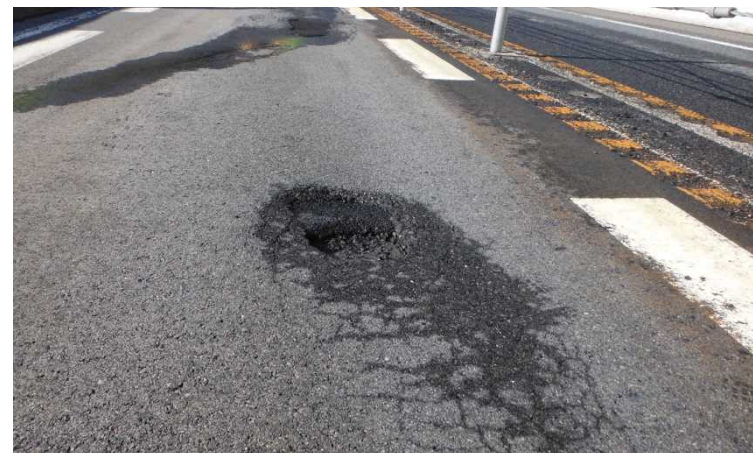
磐越道(三川～安田)の状況
