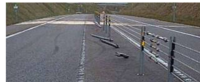
ワイヤロープの折れ曲がり状況
