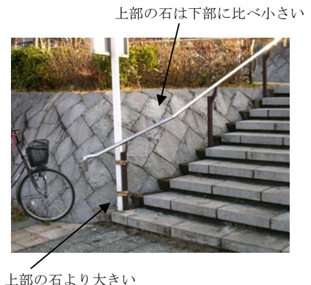
写真-1-7 巻き込み部分の石の大きさの違い
